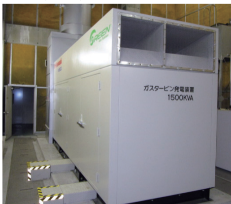
〈写真 1〉非常用自家発電装置
