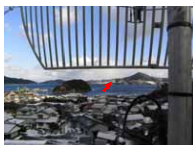
隠岐島前病院の無線LANアンテナ脇から中ノ島方向の眺望（矢印は隠岐島前高校の校舎）
