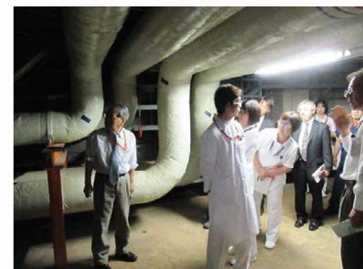
中央機械室地下ビット配管
