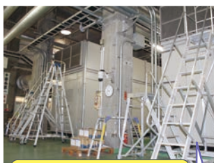
常用発電機3号・4号
