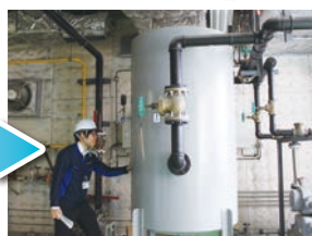
パイプを通して建物の 中のタンクへ
