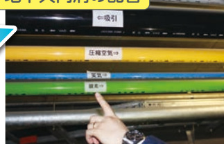
地下共同溝の配管
