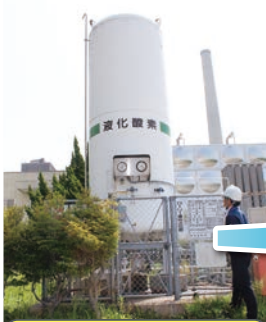
屋外の液化酸素タンク (液化酸素は約7日分の備蓄量)
