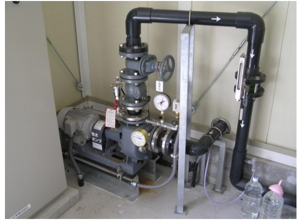
井戸水汲み上げポンプ
