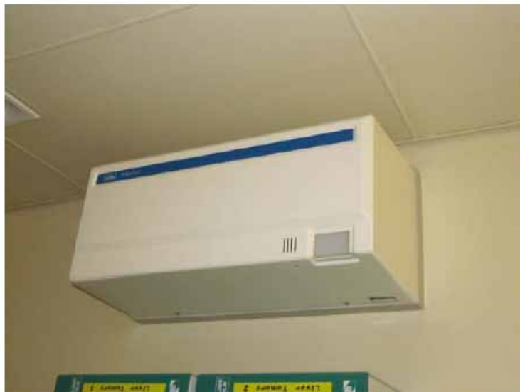
写真：所在不明となったエリアモニタの外観※
