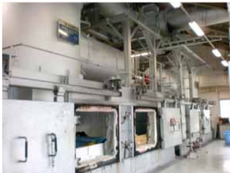
焼却処理施設
